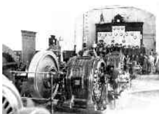
Figura Number range Figura: Centrale dei Boaletti – Sala macchine
